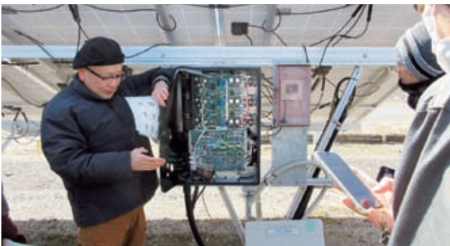
写真10 パワーコンディショナーの実機を示しての説明
